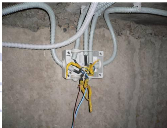
Рис. 1. Нарушение целостности изоляции электропроводов.
